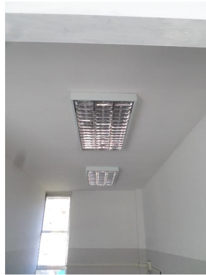
Figura 4.14 - Particolare dei corpi illuminanti ubicati nei corridoi
