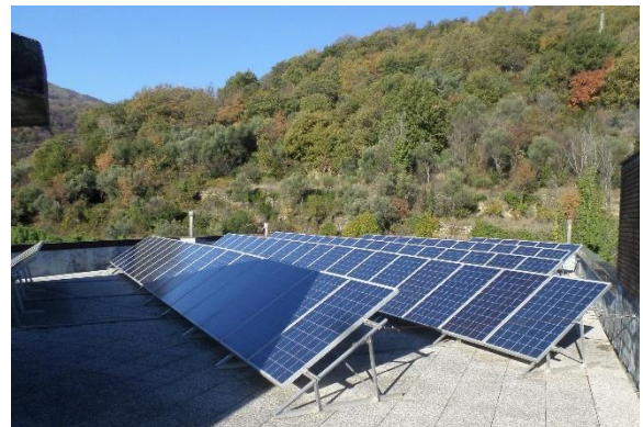
Figura 4.15- Vista dell'impianto fotovoltaico
