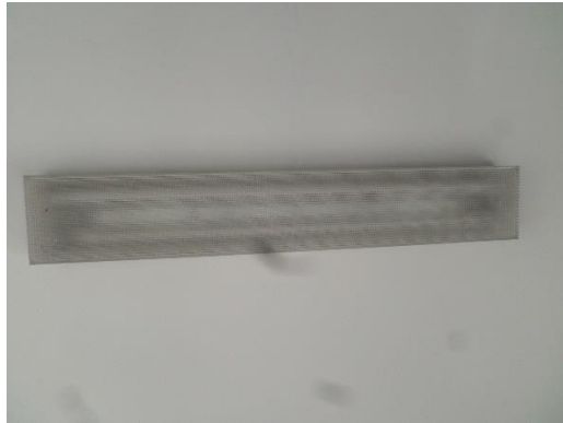
Figura 4.13 - Particolare dei corpi illuminanti installati a soffitto
